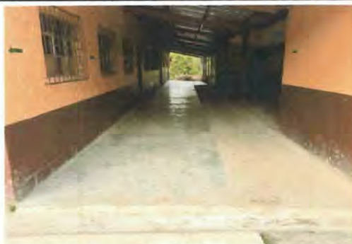
Foto 1: Falta de canales de recolección de aguas de lluvias causando daños a la estructuras, inundaciones y problemas de salud por la proliferación de mosquitos
