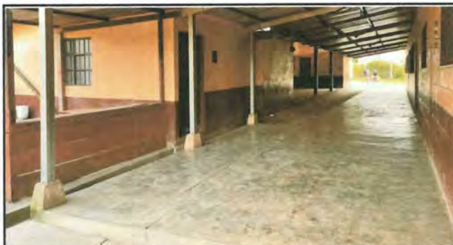
Foto 3: Se observa dañados en el piso de concreto y la falta de un nivel uniforme. Es por ello que se colocara una torta de concreto.
