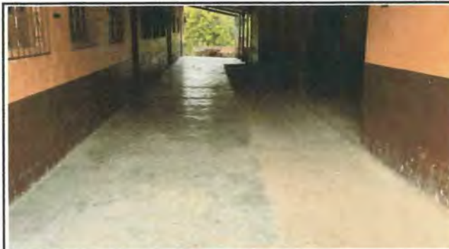
Foto 4: Se observa una falta de nivel uniforme en el área. Por lo tanto, se colocará una torta de concreto para su nivelación.
